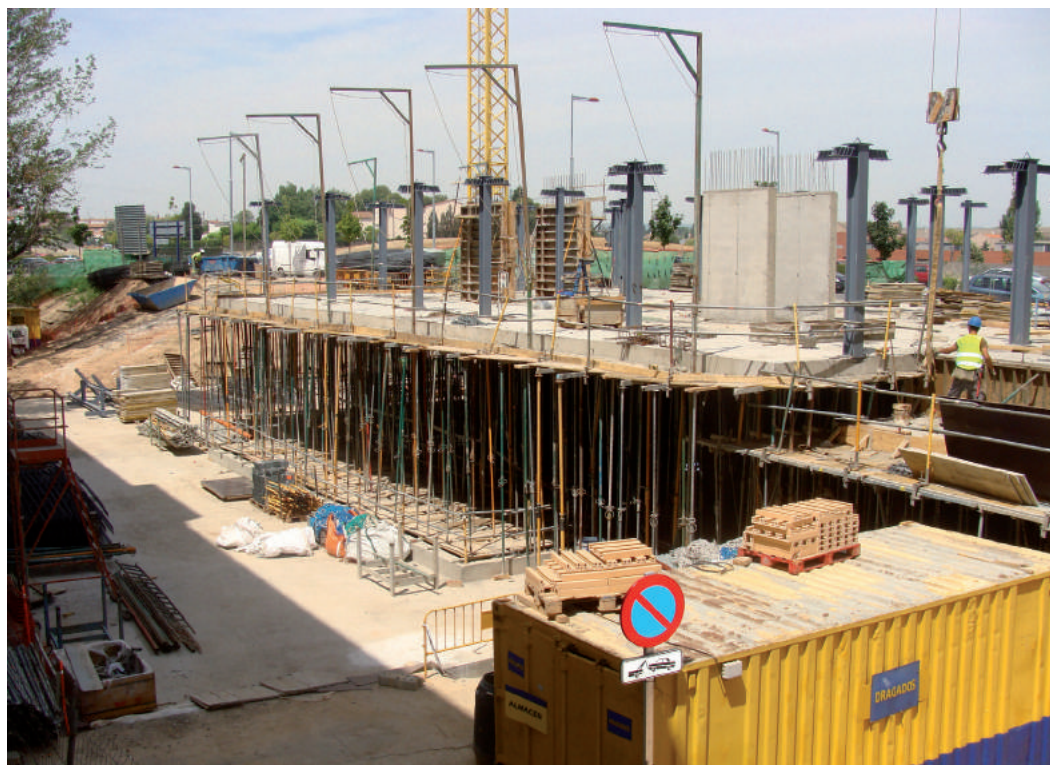
Foto 2: L'any 2012 es va acabar la construcció estructural del segon edifici de Biomedicina.
